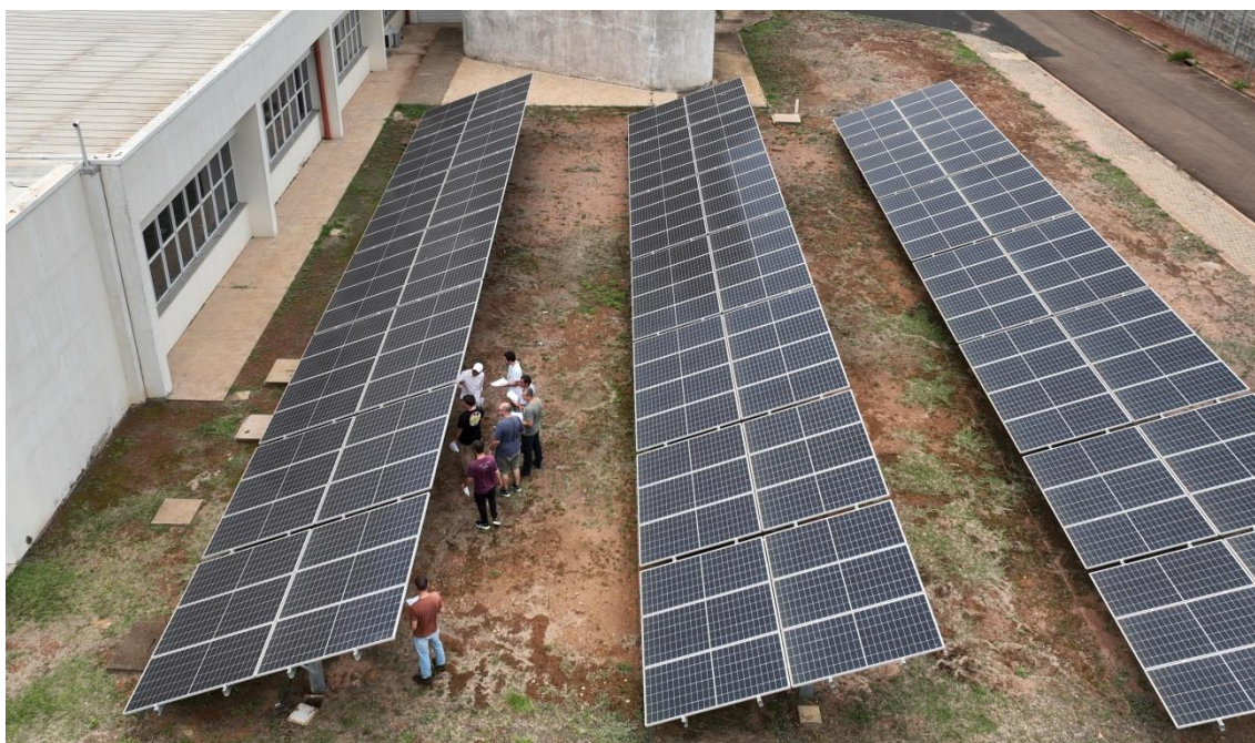
Visita programada à usina solar 60kW instalada na USP – Área II (módulo avançado).
